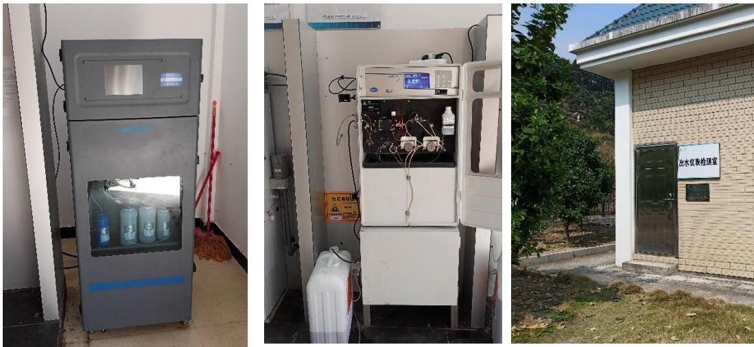
图 4.3-2 闽清梅溪污水处理厂在线监测设备
